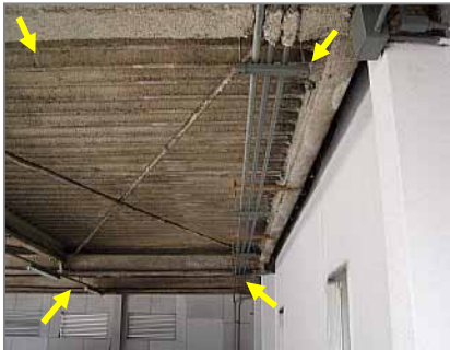
茶石綿吹きつけ
