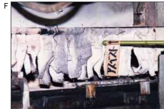
炉内覗き窓の周囲の石綿布。ガラスの加熱状況を覗く窓にすき間があり、そこから室内へ熱が逃げるため、そのすき間を覆うように石綿布をかけてあります。必要な際に、布をめくって中を覗きました。布の劣化によりばく露の可能性があります。
