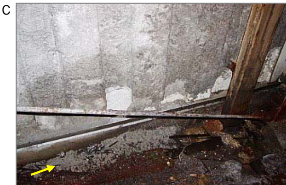
C エレベーターピット(最下部)に落ちていた耐火被覆の石綿。EVの保守要員が途中階での作業中に背中や工具類が接触して落下・堆積したものでしょうか。保守・点検時に再飛散して、作業員がばく露する可能性があります。
