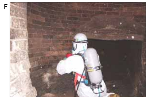
F 焼却炉用の独立煙突。耐火レンガ(原則的にはノンアス)に石綿板を接着剤で貼り付けることにより、熱を有効に使え、またレンガも長持ちします。炉の補修の際は、傷んだ石綿板を補修したり交換するなどした際に、石綿にばく露する可能性があります。
