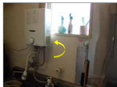
湯沸し器裏石綿含有けい酸カルシウム板 (湯沸かし器の裏やガスレンジの下は熱くなるので断熱のために使用)
