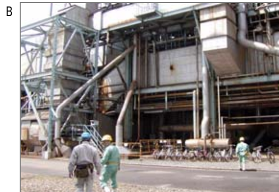
巨大な装置産業。熱風・熱源等が通る配管には断熱材が、建物には石綿含有製品が使用され、また素材への添加物として石綿が混入され、ばく露の可能性があります。
