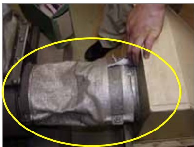
空調ほか可動継ぎ手部(表面アルミクロ ス貼)
