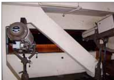
耐火ボード (競技場、劇場などのスポットライト室)
