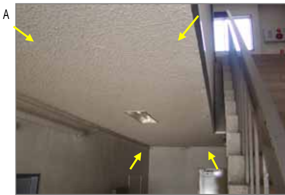
A 階段やホールの天井に吹きつけられたパーミキュライト・パーライト吹きつけ。これらにも石綿含有の時期があり飛散性石綿の分類に入っており、作業者がばく露した可能性があります。
