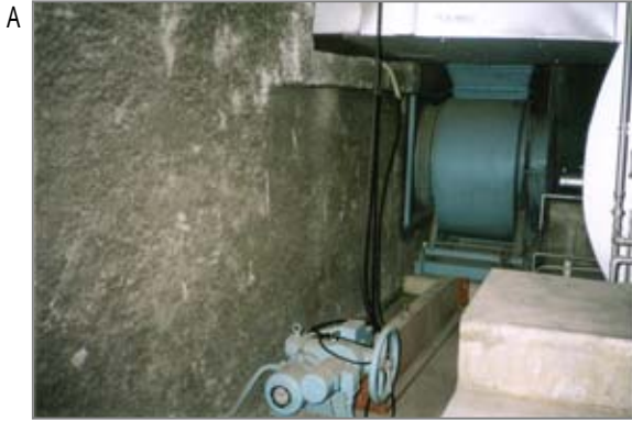
【概要】清掃工場には石綿が多用されています。断熱、騒音防止などのための建物への石綿吹きつけや含有建材(誘引機室、脱水機室、機械室他)、設備機械本体への石綿製品使用など。
