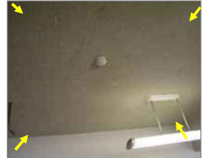
岩綿吹きつけ(石綿含有)
