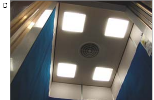
D 天井についているEVのファンを通してシャフト内の空気がEV内に取り込まれています。エレベーターの運転や案内等の係の人が、長期にわたってばく露している可能性はありますが、そのリスク評価は今後の課題です。今まで、これらの職種の方の石綿関連疾患は報告されていません。
