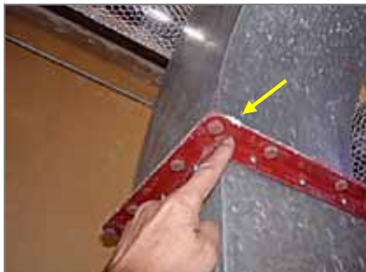
空調ダクトパッキング (ダクトの間に挟まっている白いもの)
