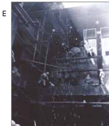
E 機関室での配管取付け作業。この作業の後に、配管には断熱材として石綿保温材を巻きつけることができました。
