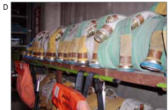
ホースも高圧の水力には破れないように金線や石綿が入っているものもありました。同じくビル内の廊下の壁などに収納されている消火栓箱も裏面などは耐火構造になっています。これらの石綿含有の耐火製品や耐火物が劣化・損傷等することにより、飛散した石綿にはばく露する可能性があります。
