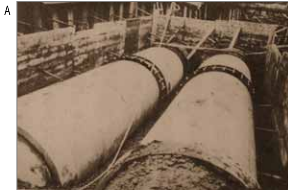
A 青石綿混入の水道用石綿セメント管。工場周辺域での石綿ばく露の可能性が指摘されていますが、取り付け現場でセメント管切断時に石綿粉じんが飛散した可能性もあります。
