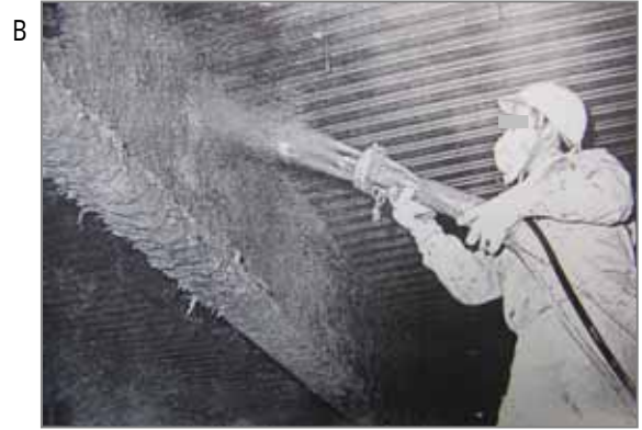
鉄骨の梁(はり)に耐火被覆として吹きつけているところです。この作業周辺は粉じんが舞っていて、作業者や周辺で作業をしていた者が高濃度ばく露した可能性があります。
