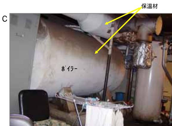
C ボイラー(お湯を沸かす装置)本体の全周囲に保温材が施工されています。そのボイラーから派生する管にも熱が冷めないように保温材が巻かれています。劣化・破損に注意。
