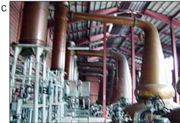
C 洋酒工場の蒸留装置。寒冷地にあるため建物の結露防止で吹きつけ石綿が施工されています。装置内に石綿粉じんが入ることはありませんが、吹きつけ石綿の劣化や損傷により、作業員が石綿粉じんにはく露する可能性があります。
