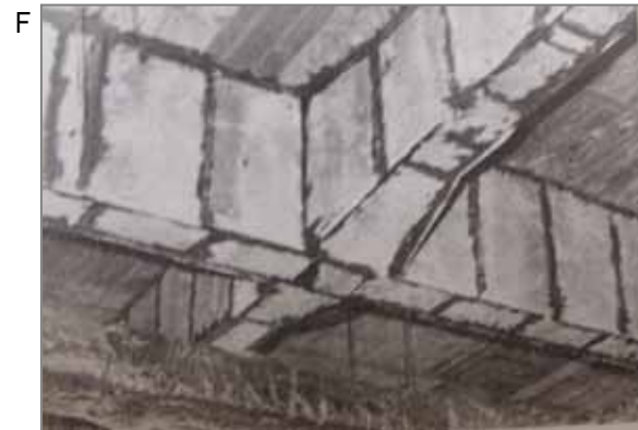
左の石綿耐火被覆板を梁に貼ったところ。釘・かすがい・接着剤(石綿入り)で施工しました。収まりを良くするために、現場で材料を形に合わせて切断することは必要な作業ですが、吹きつけ工法よりは粉じんの発生は少ないです。
