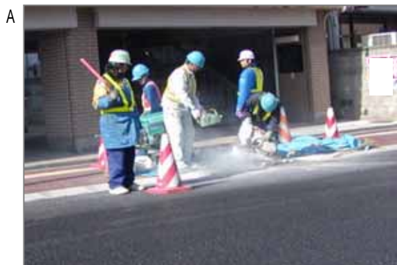
道路工事、補修作業時には粉じんが発生します。アスファルトにかつて石綿が混入していた区間においては、石綿粉じんばく露する可能性があります。
