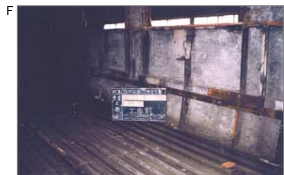
左同。吹きつけ石綿除去前の車両内部。この車両の製造時は窓に目張りをして石綿を吹きつけました。狭い空間ですので粉じん濃度が高くなっていた可能性があります。
