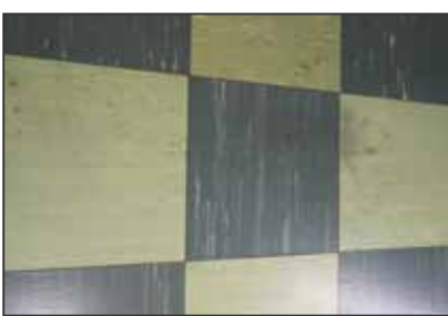
石綿含有ビニル床タイル
