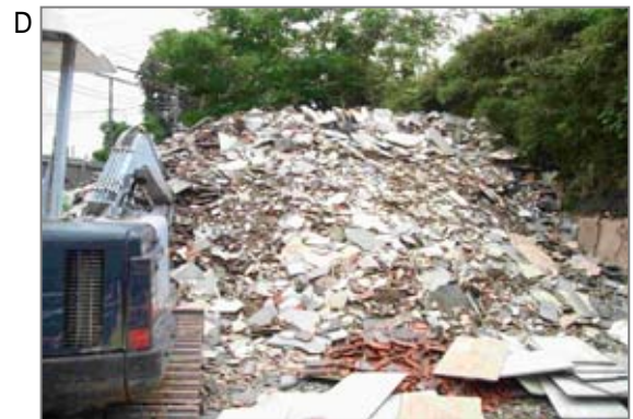
瓦工事業者の廃材置き場です。石綿の含まれない日本瓦と石綿含有屋根材が混在して捨てられていました。重機などを用いた積み替え等は、粉々になり、粉じんが飛散しますので注意が必要です。
