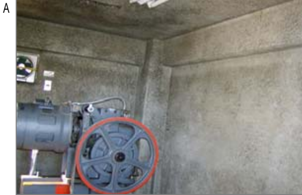
A エレベーター(EV)機械室は最上階にあり結露防止のため吹きつけ石綿があります。ワイヤーロープを停止階で停めるための石綿含有ブレーキライニングも巻上げ機についています。吹きつけ石綿の損傷や劣化による石綿の飛散、石綿含有ブレーキライニングの摩擦による発じん等により、修理・点検等の際にばく露する可能性があります。
