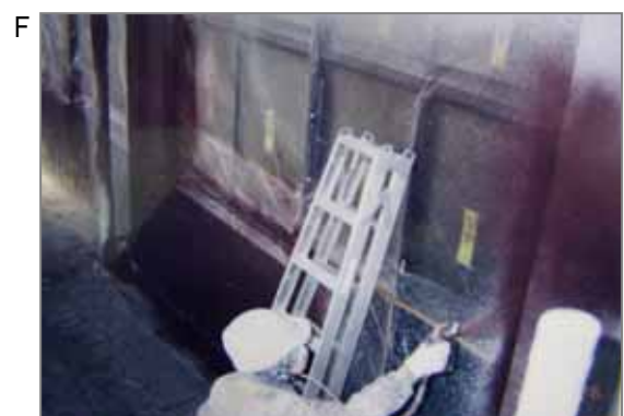
F 塗装(ガン吹き)工事。塗料には顔料、沈降防止剤、増量剤、流動性増進剤などの目的で白石綿混入のタルクがはいっていました。
