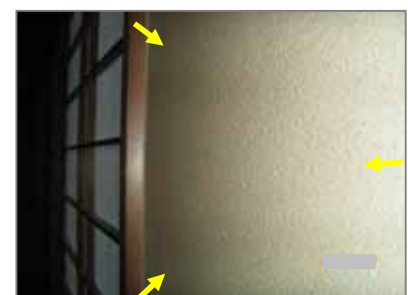
砂壁状吹きつけ(石綿含有)
