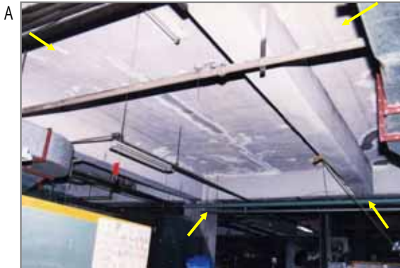
【作業環境】ガラス製造工場は高熱作業があり、設備・装置機器への保温材・断熱材・絶縁材等はかかせません。写真は加熱炉が設置されている建物の天井断熱材としての吹きつけ石綿。
