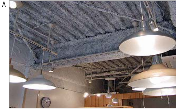
店舗、ヘヤーサロン、ゲームセンター等の耐火被覆の露出天井。石綿含有吹きつけの場合、劣化や損傷により石綿繊維が飛散し、このような環境で労働をした従業員が長期にわたってばく露をする可能性があります。
