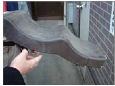
板金屋根上乗せ石綿屋根材
