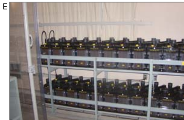
バッテリー室(電源室)。ソーダ工業・硫安工業なども含め、電気隔膜に石綿板・石綿織物が使用されていました。電気隔膜の交換時にばく露する可能性があります。
