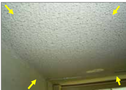
パーライト吹きつけ(石綿含有)
