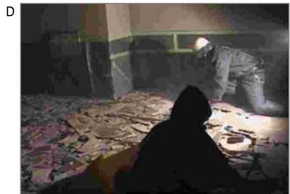
D 天井の石綿セメント板(フレキシブル板)をパールで破壊し、かき集めているところ。破碎に伴い、粉じんが舞っています。
