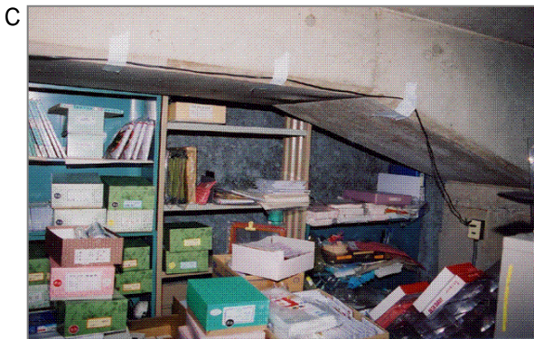
倉庫の壁に青石綿が吹き付けられていますが、経年劣化しており、飛散しやすい状況でした。この倉庫に、業務のために毎日数回出入りをされていた方が中皮腫を発症されました。
