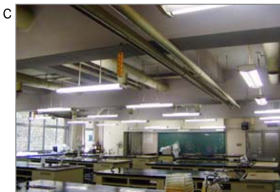
C 学校の実験室の天井に吹きつけ石綿があります。パーナーやアルコールランプなど火を使うため、耐火・結露防止目的と考えられます。一部、大きく脱落している箇所があり、露出した破損部から飛散した石綿に、教員が長期にわたってばく露した可能性があります。
