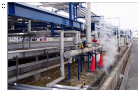
石油精製、化学プラント関係では多種多様な石綿製品が使用されていました。配管保温材・シール材などメンテナンス工事の際の、ばく露対策は重要です。
