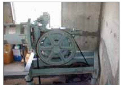
エレベーター最上部ブレーキパッド (この写真には写っていません)
